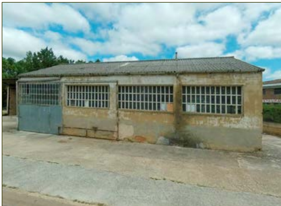
Edificación industrial en mal estado de ornato
