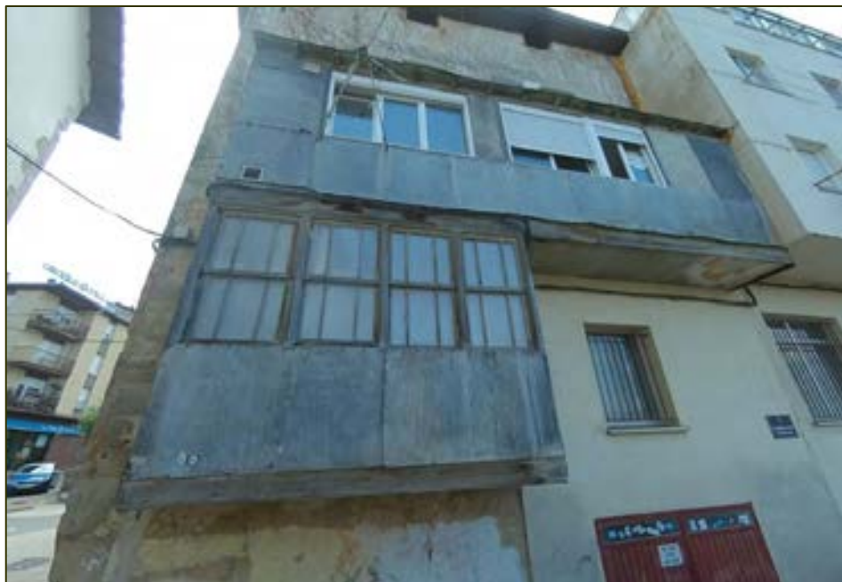
Edificio en mal estado de ornato junto al Ayuntamiento, en calle Debajo de las Casas
