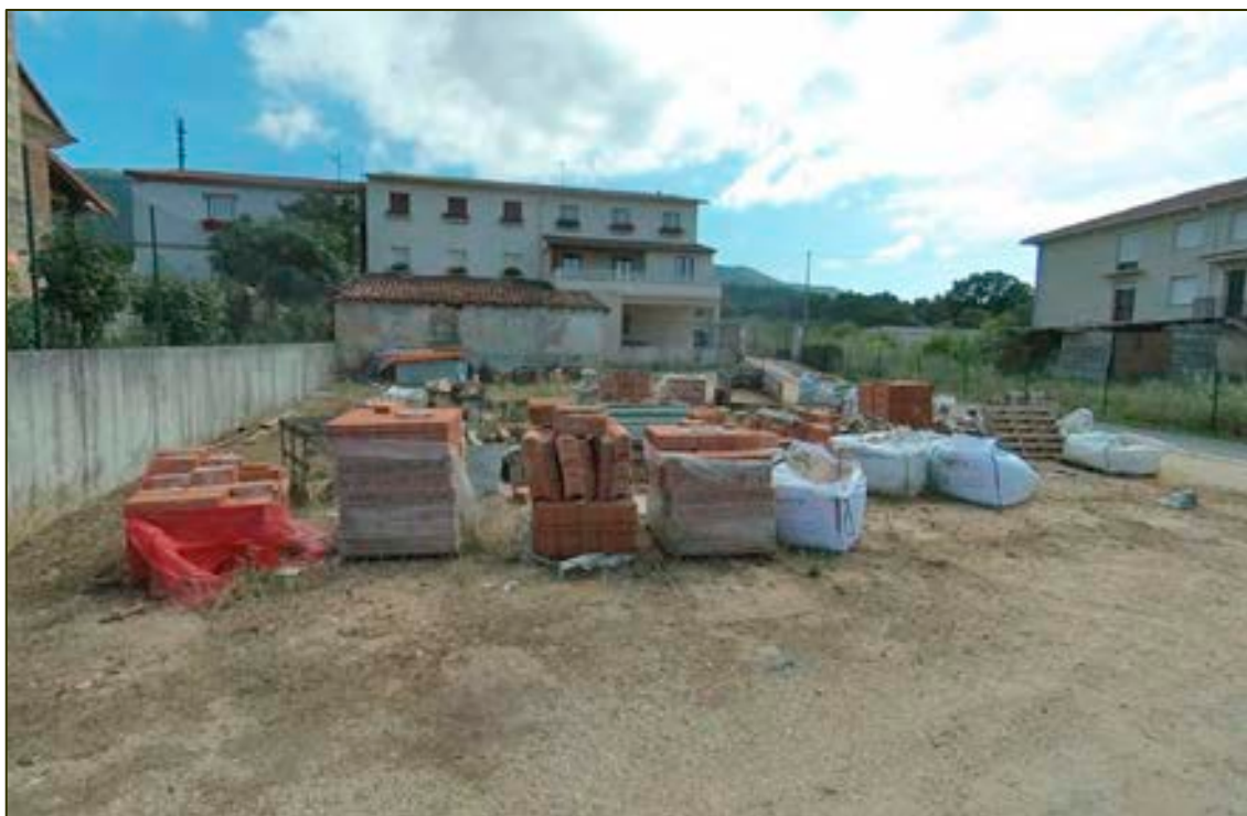
Acopio de materiales de construcción sin obra en la parcela, en calle Yoar
