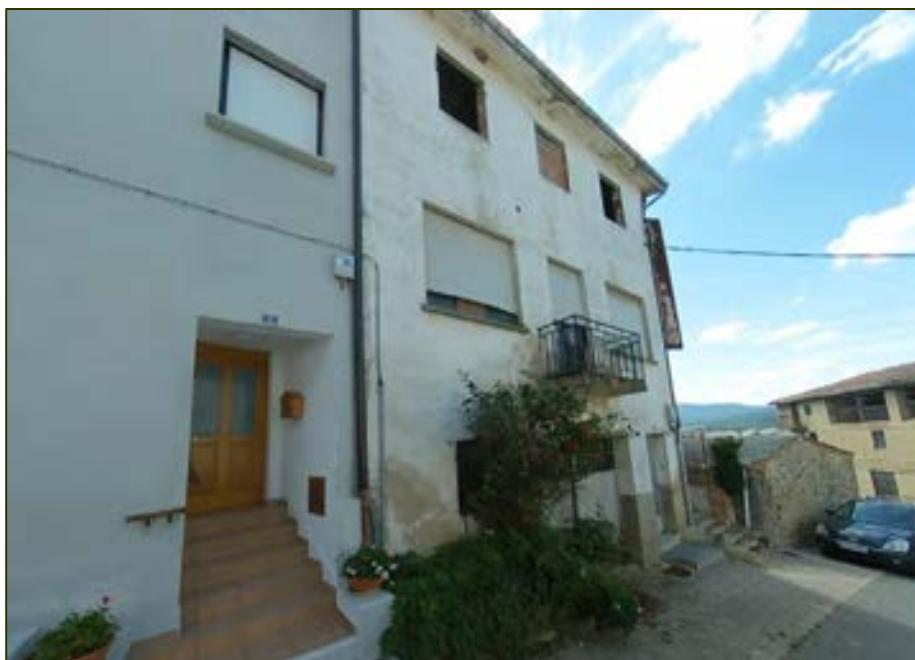
Edificio semiabandonado en calle Potro
