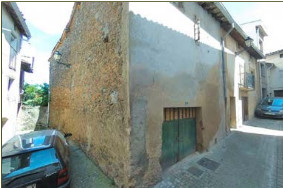
Edificio en mal estado de conservación de fachada en callejón de Arrabal
