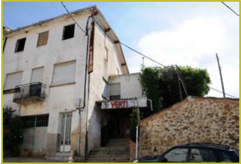
Edificaciones en estado de conservación deficiente.
