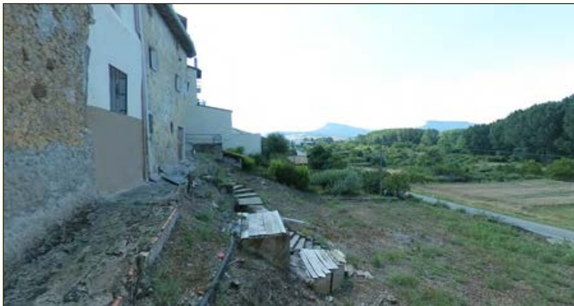
Zona de traseras degradadas a la altura de calle Arrabal
